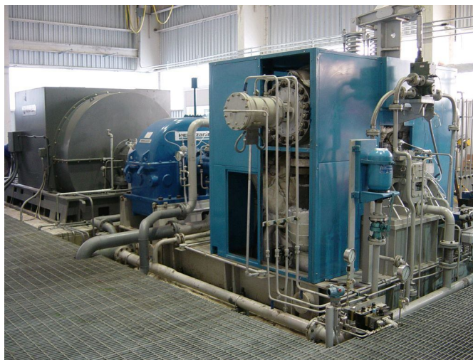
Figura 15: Exemplo de um conjunto turbo-gerador.
