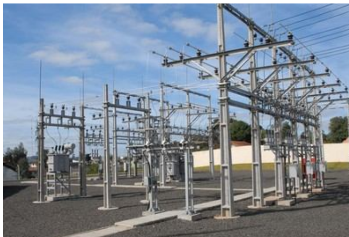
Figura 16: Exemplo de uma subestação elevatória de tensão.
