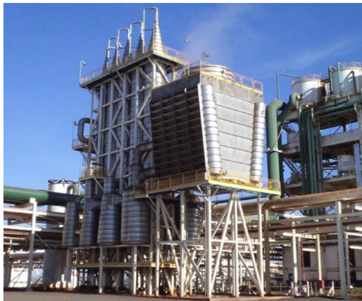
FIGURA 11: CONCENTRADOR DE VINHAÇA COM CONDENSADOR EVAPORATIVO
